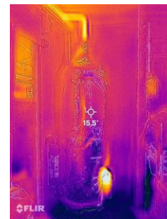
Figure 6: Chauffe-eau isolé de la laiterie (T=15°C)
