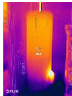
Figure 5: Chauffe-eau non isolé de la laiterie (T=19°C)
