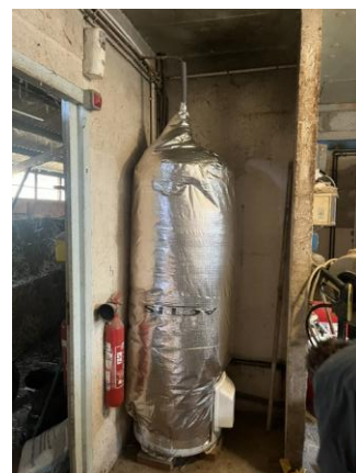
Figure 1: Chauffe-eau de la laiterie isolée
