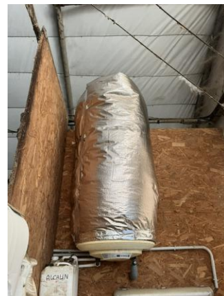
Figure 2 : Chauffe-eau des chevrettes isolées
