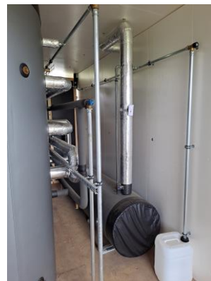
Le réservoir de stockage du glycol est situé dans le container, sous le niveau des capteurs solaires.
